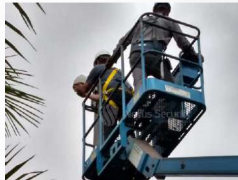
Instalação Speed Dome na empresa Diosynth
