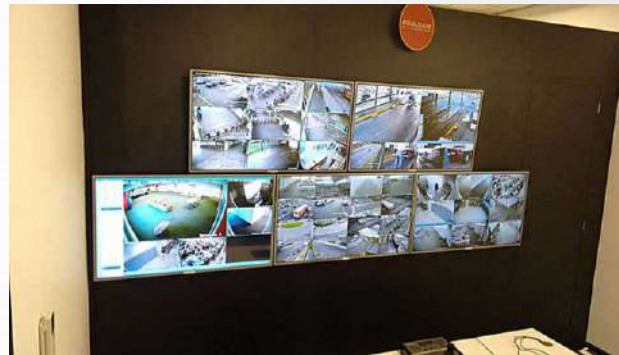
Projeto e instalação - Sala de monitoramento na JBS - Anhanguera
